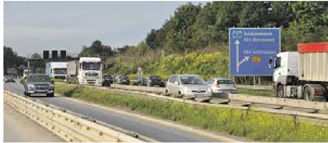
Weniger Verkehrsprobleme bei den Bauarbeiten an der A7, als erwartet: Das Konzept der Verantwortlichen um die VSN, mit Schaffung von knapp fünf Kilometer Erholungsphasen den Verkehr auf den eingeschränkten Fahrbahnen zu entlasten, geht auf
