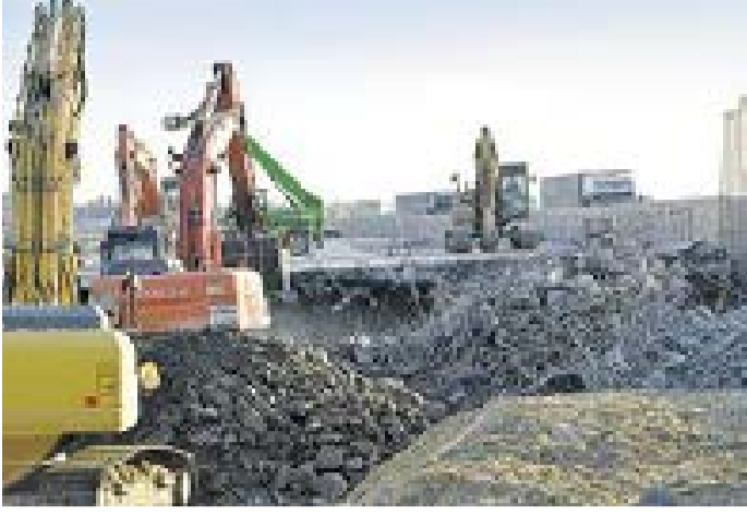
Waren über Monate im Dauereinsatz: Die Abbruchbagger mit ihren großen Stößeln zertrümmern die alte Betondecke an der Brücke
