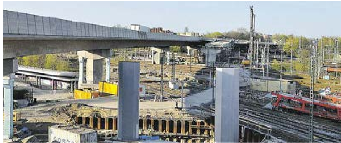
Der östliche Teil der alten Betonbrücke ist abgetragen: Deutlich erkennt man die flächenmäßige Dimension des Baufeldes und die Besonderheit des Brückenbaus bei laufendem Bahnbetrieb.
