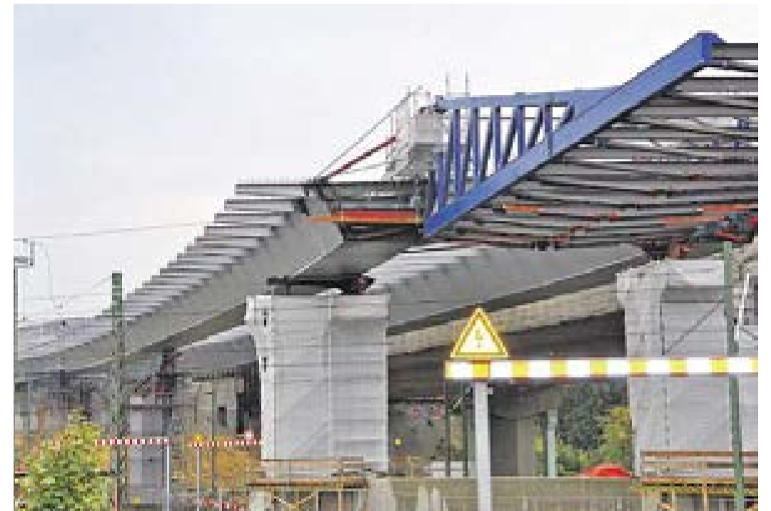
Im Zuge des weiteren Baufortschritts wird die Brücke im Takteller Süd, wie auf dem Foto zu erkennen ist, mit variabler Verschiebetechnik unter Einbeziehung eines hydraulisch angesteuerten Vorbauschnebels in Richtung Norden verschoben. Während dieses Vorgangs ist wieder höchste Präzision erforderlich, um die geometrischen Ansprüche des Bauwerkes durch einen ständigen Soll-Ist-Abgleich und entsprechende Korrekturen zu meistern
