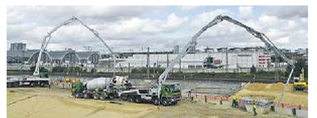
Moderne Betonförderertechnik durch KBK in Hamburg: Beim Ausbau der neuen U4-Bahntrasse in Richtung Elbbrücken wird der Frischbeton von Mischfahrzeugen mittels Pumpen über Fördersteme in den Trog transportiert
